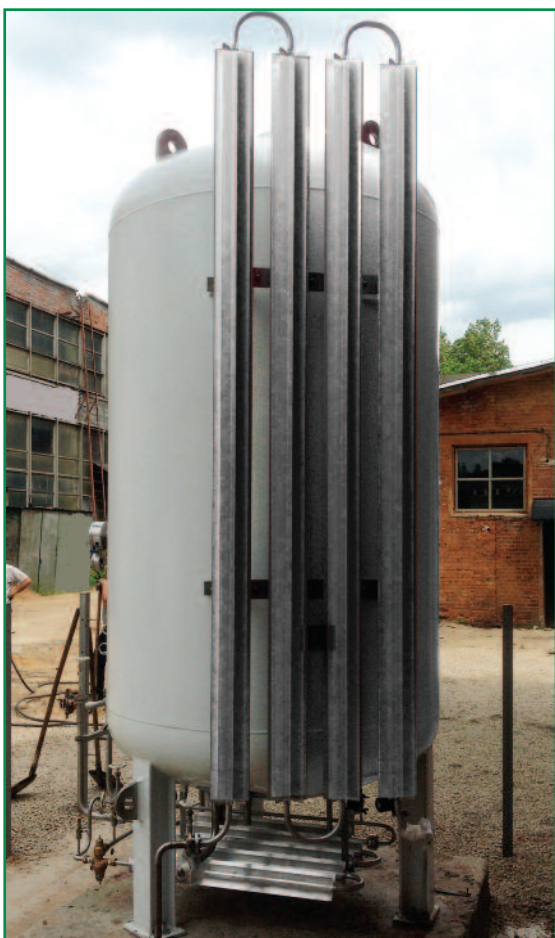
Фото 2. Навесной испаритель ИС 0045-Н, смонтированный на ёмкости VRV 3000/18, в составе системы хранения и газификации аргона (ОАО «ВИЛС», г. Москва).
