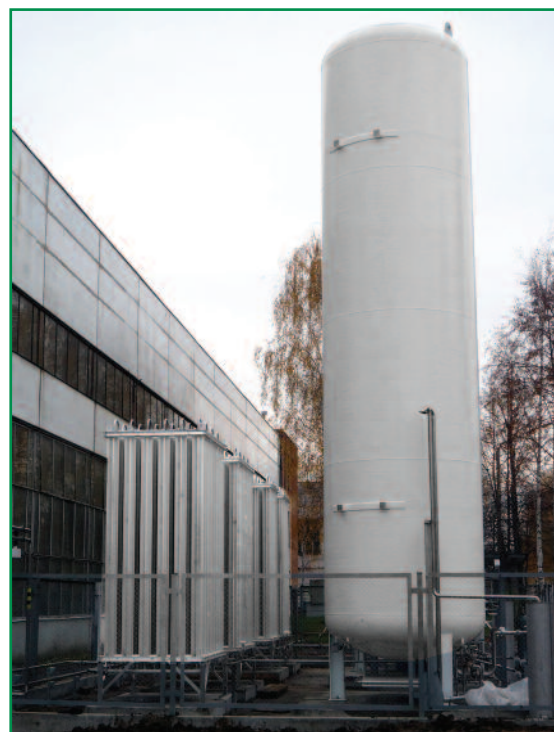
Фото 3. Испарители ИС 0570-С и ИС 0430-С системы хранения и газификации азота и кислорода (ОАО «Сатурн – Газовые турбины», г. Рыбинск)
