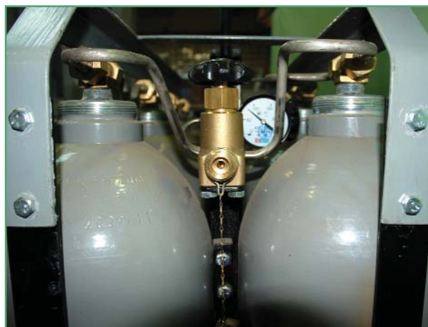
Фото 5. Моноблок с установленным на нём манометром
